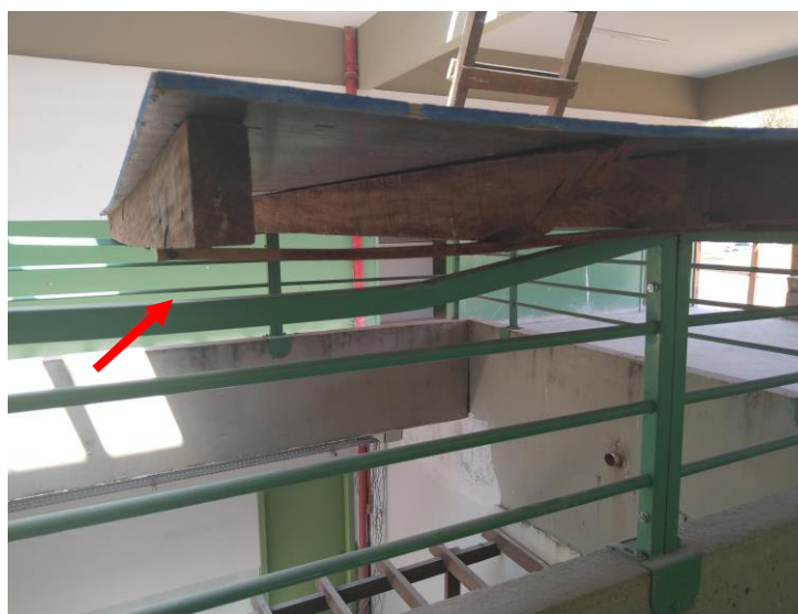
Figura 12 - Plataforma de andaime montada sobre o guarda corpo da edificação Fonte: Próprio autor (2019)
