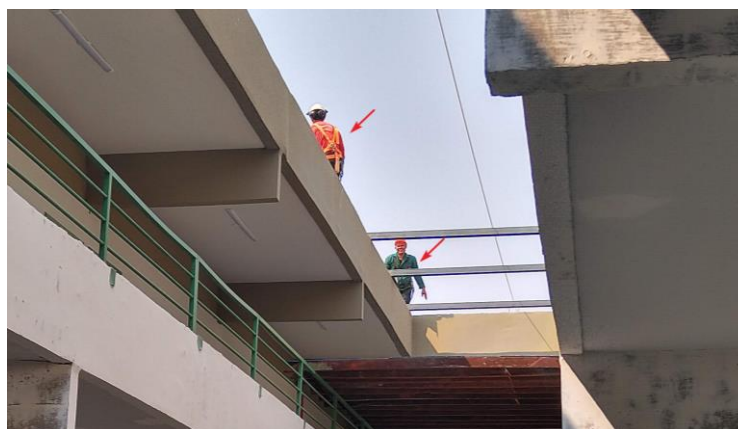
Figura 6 – Trabalho em altura sem proteção adequada Fonte: Próprio autor (2019)
