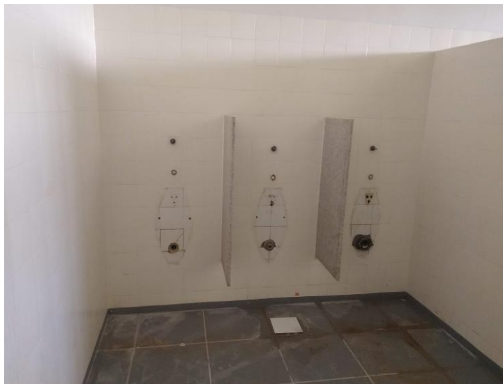
Figura 3 – Mictórios ausentes no sanitário dos funcionários Fonte: Próprio autor (2019)
