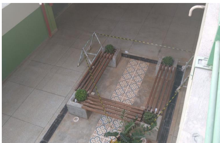
Figura 11 – Isolamento executado de forma inadequada Fonte: Próprio autor (2019)
